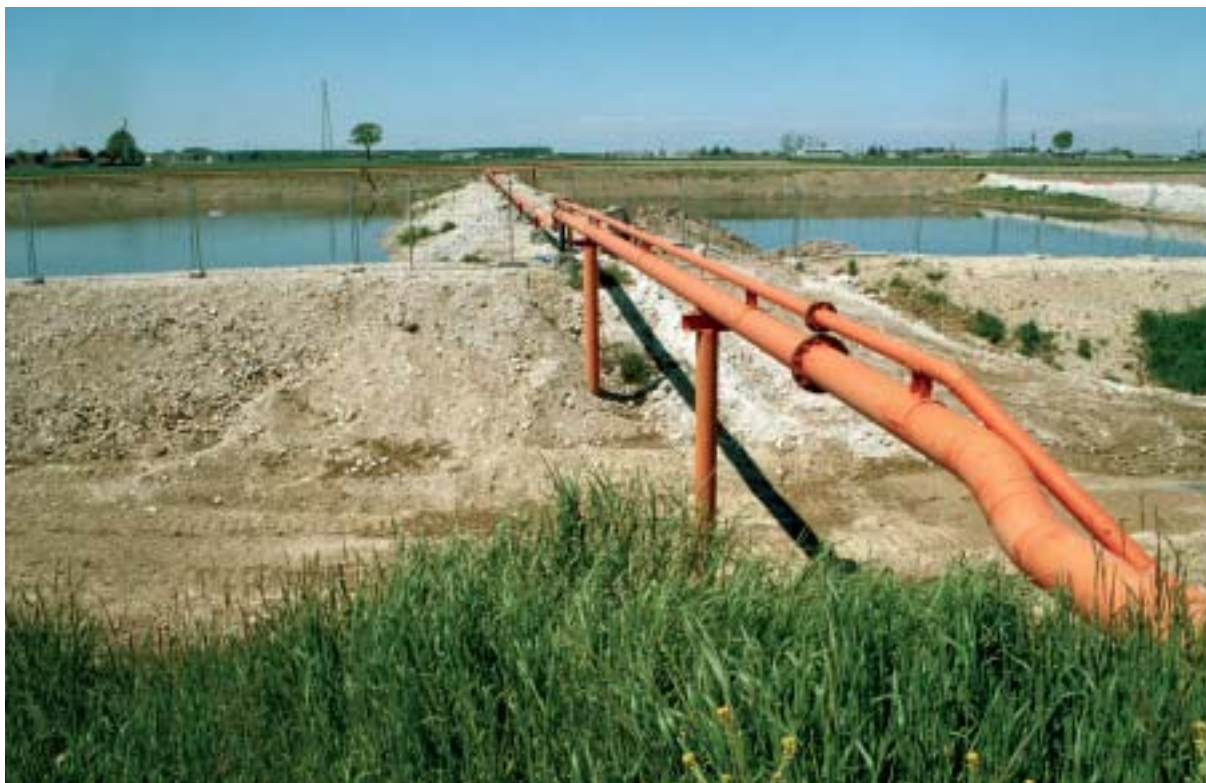
Utilizzo dei residui terrosi, contenuti nelle acque di lavaggio delle barbabetole, per il tombamento delle fosse di cava
