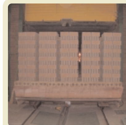
LA BOCCA DI INGRESSO DI UN FORNO A TUNNEL
