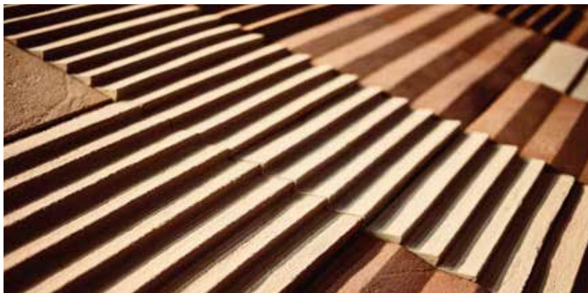
Fig 2 Dettaglio di posa con le diverse tipologie di piega / Detail of laying with different types of fold
